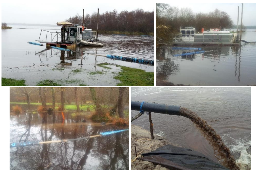
Figure 11 : Exemple de petite DAS et vues de conduites de refoulement
